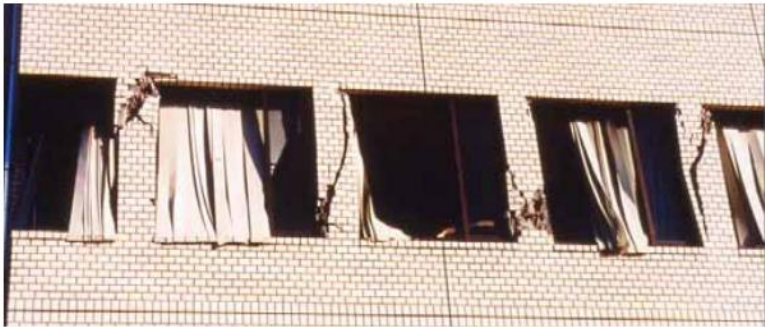
شکست برشی ستون کوتاه
