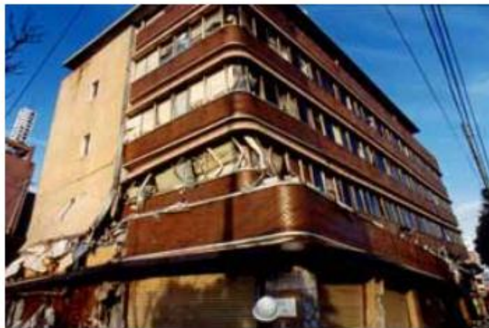
تخریب یک ساختمان به علت نادیده گرفتن اثر سختی دیوار (کوبه ۱۹۹۵)
